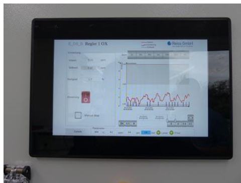
Bild 7 : Alles im Blick - Der Anwender bekommt ein vollumfängliches Bild seines Anlagenzustands auf dem Webpanel
